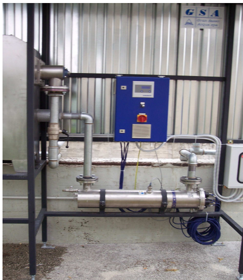
RIUSO DI ACQUE REFLUE URBANE: IMPIANTO PILOTA PER DISINFEZIONE CON UV
